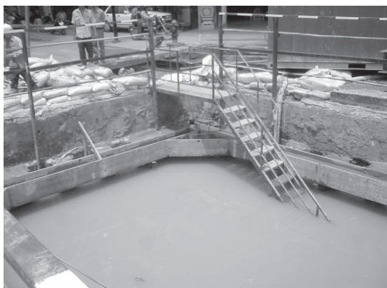
写真一5 推進設備の矢先に道路陥没、立坑水没
