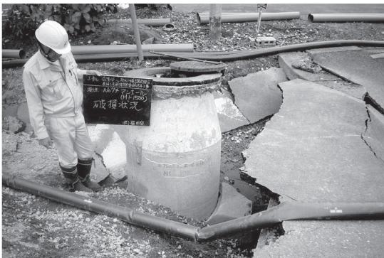
写真-3 突出したマンホール (3)
