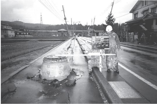
写真-1 突出したマンホール (1)
