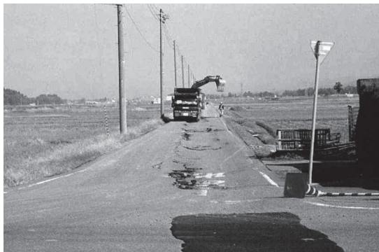
写真一六 沈下した開削部（１）
