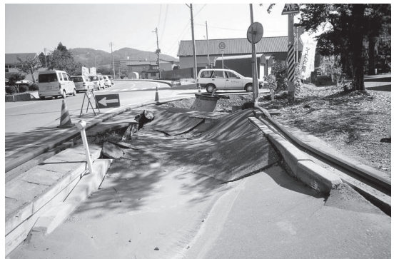
写真-4 沈下した開削部 (1)
