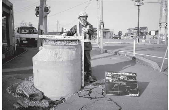
写真-2 突出したマンホール (2)
