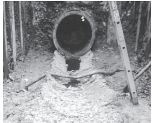
写真-1 推進管底部の滑材状況
