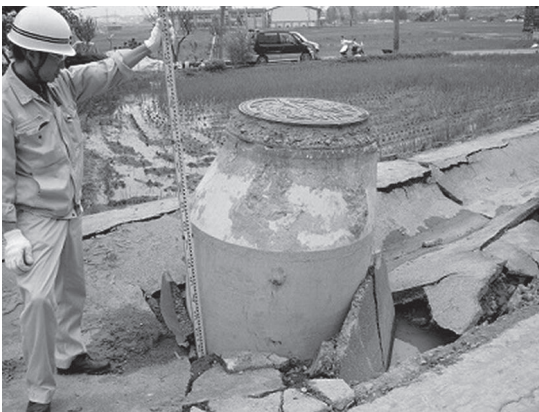
写真三 マンホール浮上被害状況（その2） ※3
