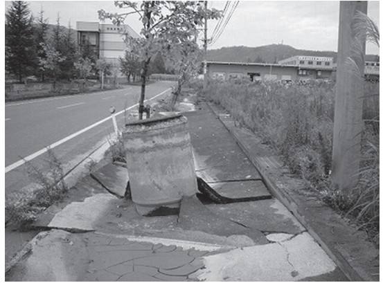
写真二 マンホール浮上被害状況（その1） ※2
