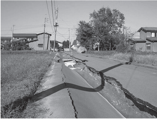
写真一 管渠埋設部の道路陥没状況 ※1
