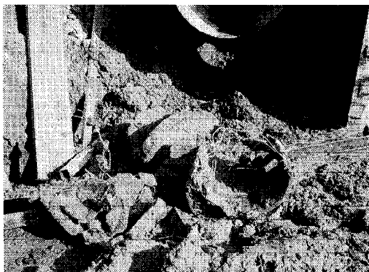
写真-9 コンクリート管が排出された状況
