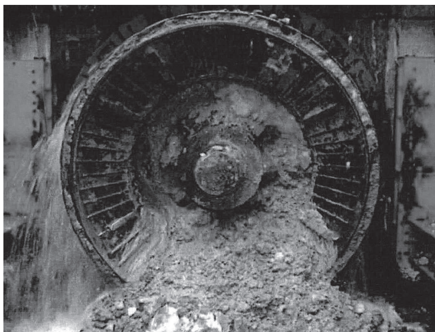
写真-6 到達時カッタ脱落
