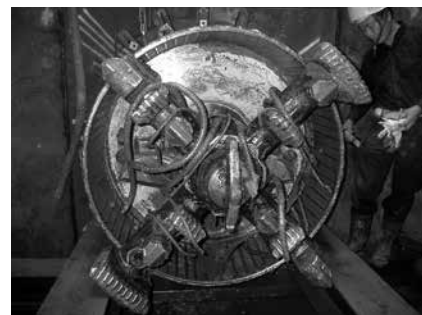
写真-5 到達状況: カッタースポークに絡みついた鉄筋(φ1800場所打ち杭PC棒鋼)
