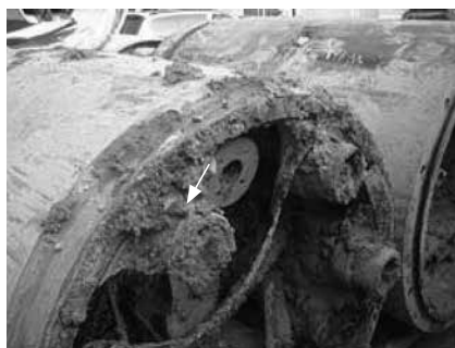
写真-2 方向修正ジャッキ破断
