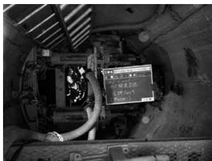
写真-4 φ2000立坑内設備
