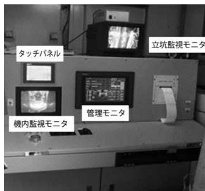
写真-1 集中管理室
