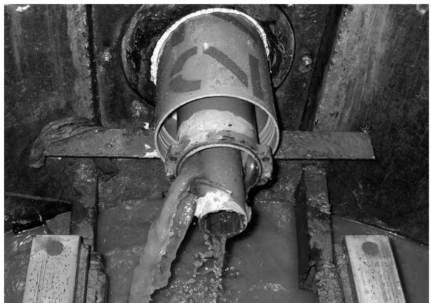
写真-1 27m付近で発生した湧水
