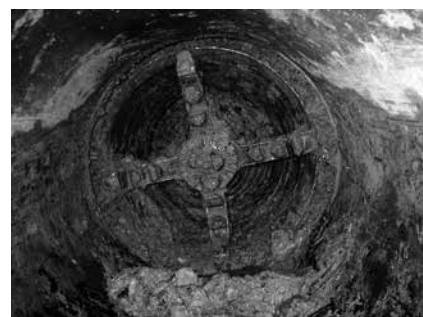
写真-3 内部ギアが破損した掘進機とドッキングした状態
