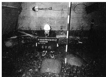
写真-1 立坑掘削時に確認された巨石
