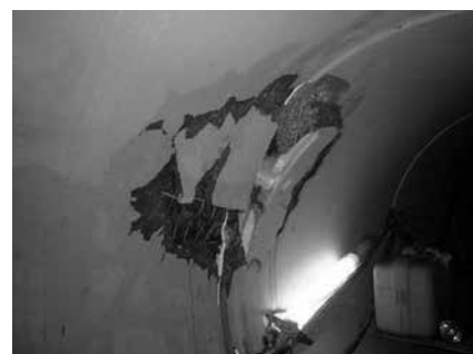
写真-5 推進管破損状況
