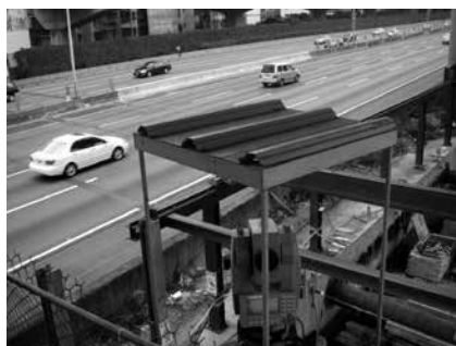
写真－1 三重自動沈下計測設置
