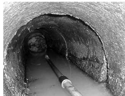
写真-3 管路が土砂で閉塞している状況
