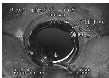
写真二 下水管きよの損傷状況 (塩化ビニル管の継手損傷)
