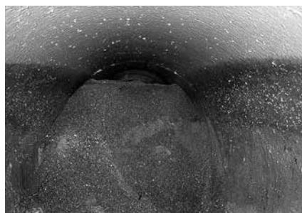
写真一 下水管きよの損傷状況 (継手損傷による土砂流入)
