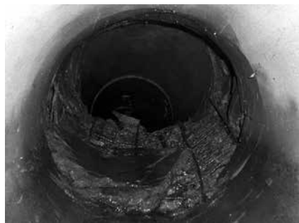
写真-1 被災管きよ状況
