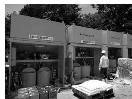
写真－1 液性固結型滑材用プラント
