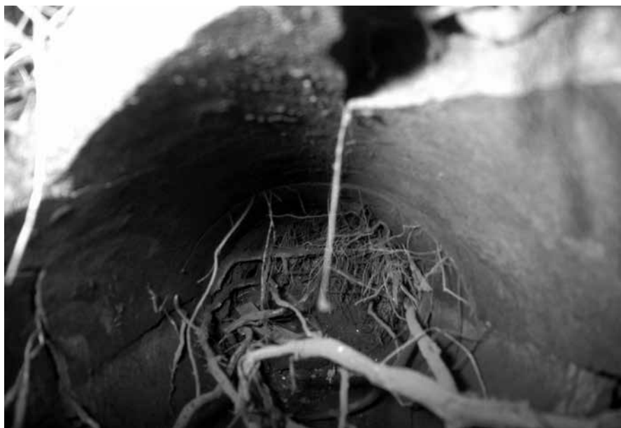
写真-1 管路の上部が破損して土砂が管内に流れ込んでいる状態
