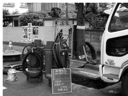
写真-2 22kW ポンプ
