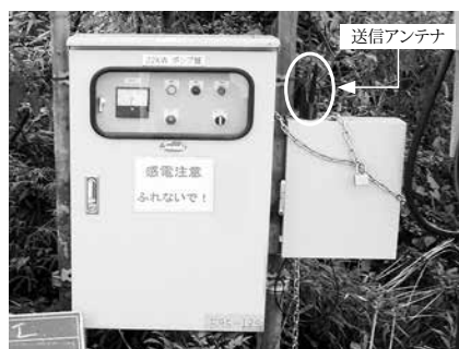
写真-5 22kW ポンプ起動盤 (メール機能付)
