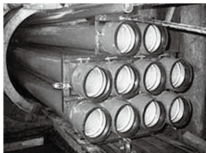
写真-1 内部配管状況
