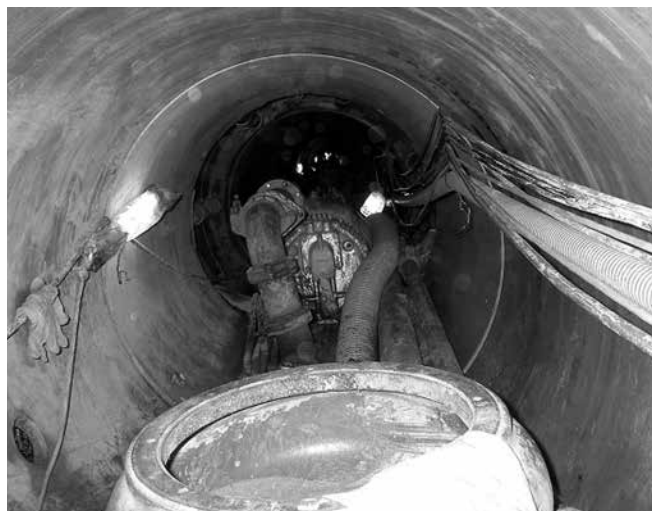
写真-4 送泥ポンプの悲鳴（長時間使用によるケーシング疲労）
