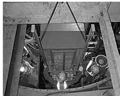
写真－2 設置状況②
