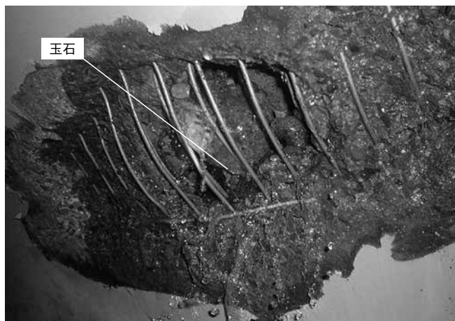
写真-4 破損した推進管
