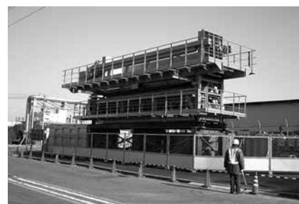
写真-2 二次処理プラントフィルタプレス
