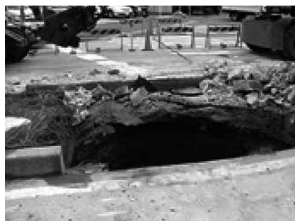
道路陥没状況
