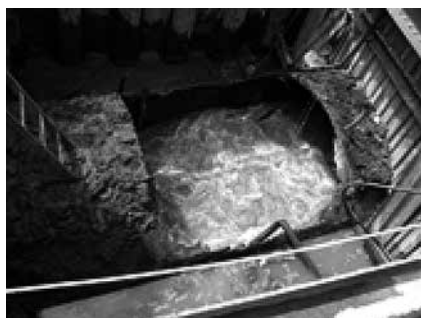
本管上部破損状況
