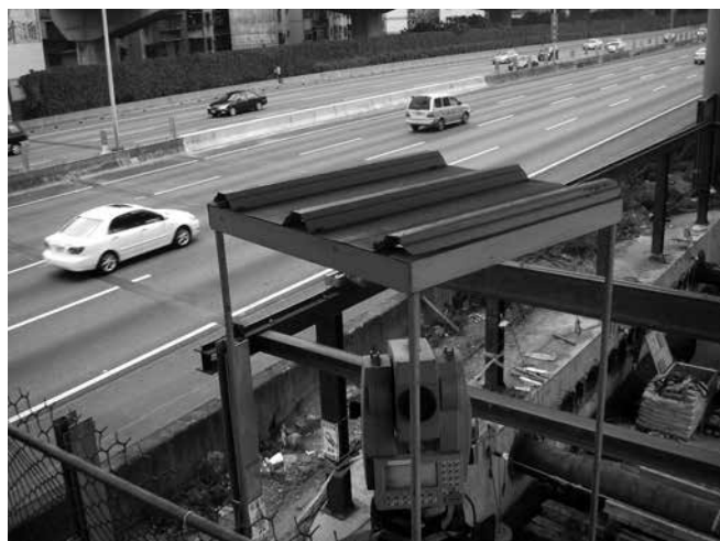
写真-1 三重自動沈下計測設置
