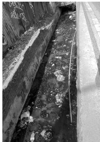
写真－1 汚染された水路
