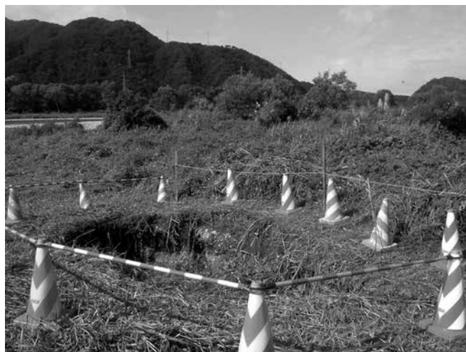
写真-1 陷没箇所
