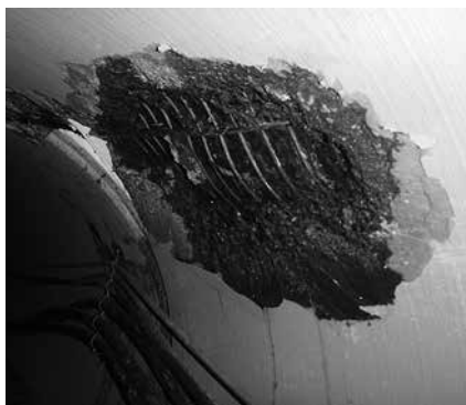
写真-1 1回目の推進管破損状況
