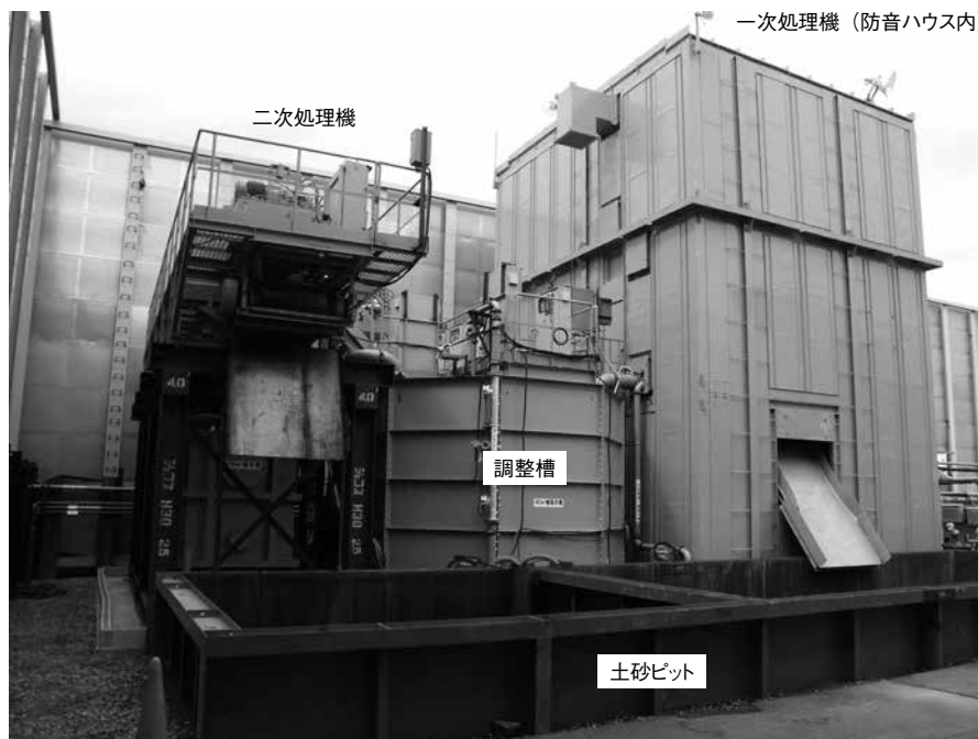
写真-1 処理プラント全景
