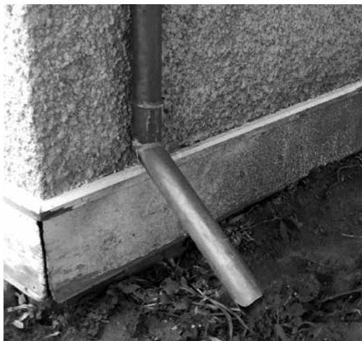
写真一 屋根からの雨水を庭先に出している例 （カナダ、トロント市の民家）
