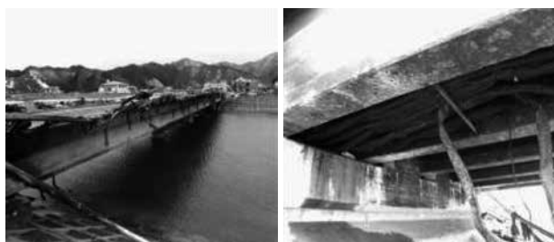
写真-3 橋梁下部に設置された中継伝送路の被災
