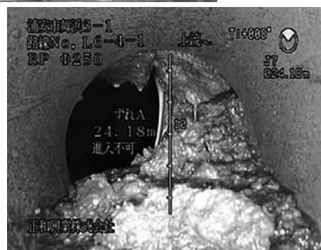
写真-5 管路の被害
