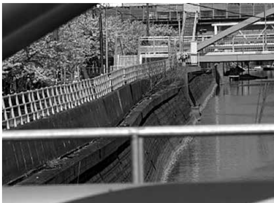
写真-4 河川護岸の被害
