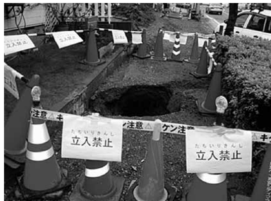
写真-6 マンホール躯体のズレによる道路陥没
