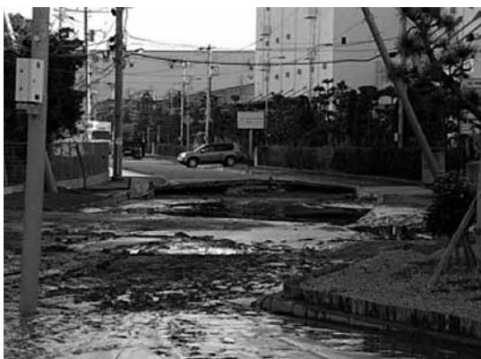
写真-2 道路の被害
