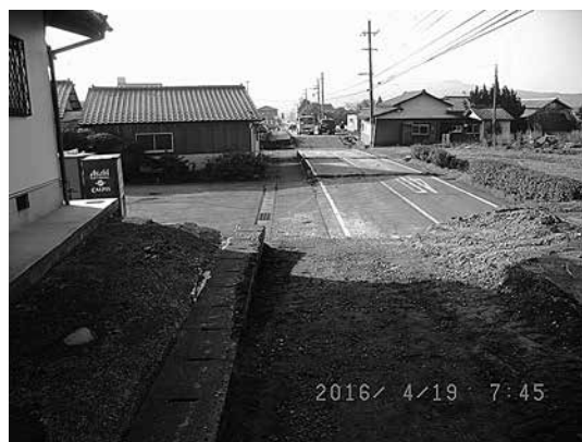
写真-3 4月19日朝に改めて撮影した陥没箇所①
