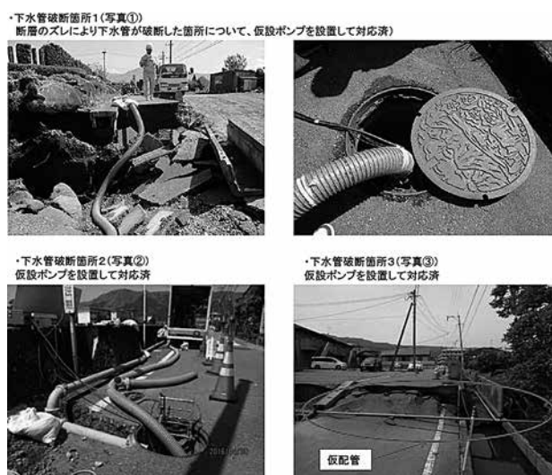
写真-1 下水道破断箇所写真 (国土交通省WEBサイトより引用、平成28年6月17日)
