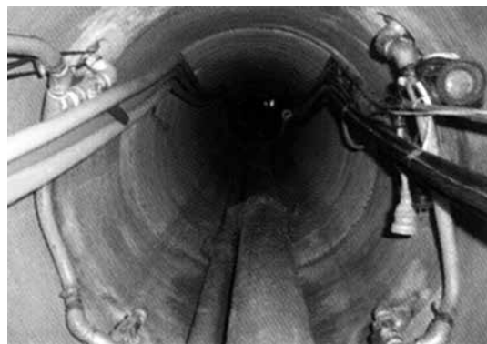
写真－5 管内設備
