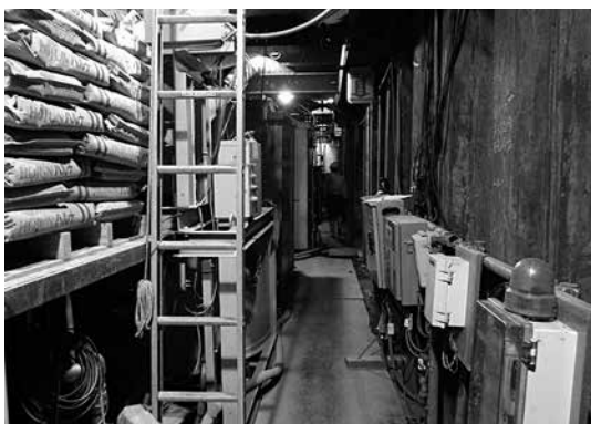
写真－2 地下利用式プラント①
