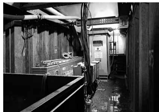
写真－3 地下利用式プラント②
